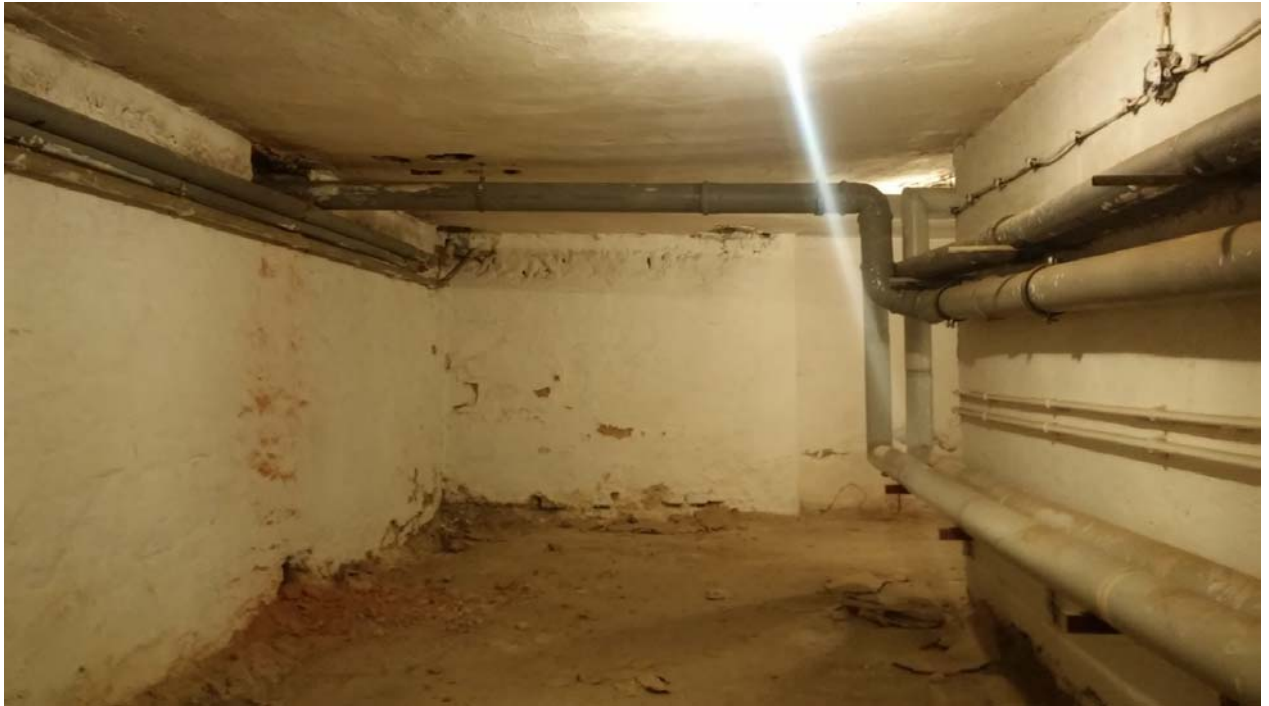
Foto.11 Podpiwniczenie - układ instalacji wod. -kan. i C.O
