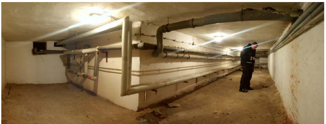
Foto.12 Podpiwniczenie - instalacja sanitarna i C.O.
