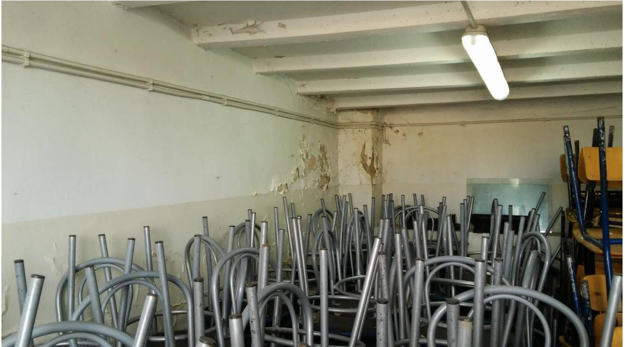
Foto.7 Wnętrze magazynu - widoczne uszkodzenia ścian i sufitów na skutek zacieków wody deszczowej
